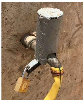
Mecanismo de protección de un grifo implantado por el comité de gestión de la fuente comunitaria situada en la comuna de Yène
